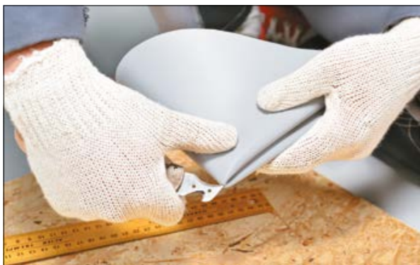
13. Сделайте отверстие с помощью кровельного ножа, для того чтобы найти центр окружности.
