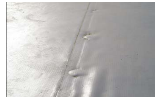
Рис. 3.5.7 Дефект сварного шва
