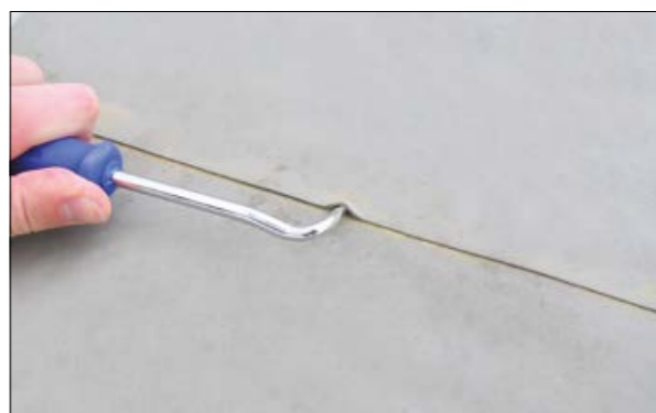
Рис. 5.2.9 Контроль при помощи специальной чертилки
