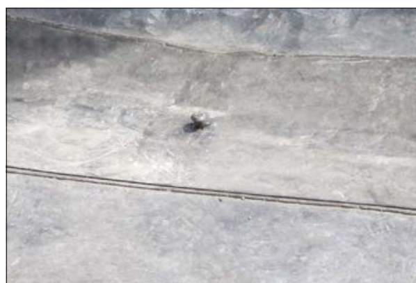
Рис. 3.5.10 Повреждение мембраны шляпкой самореза при применении тарельчатого металлического держателя по минераловатному утеплителю
