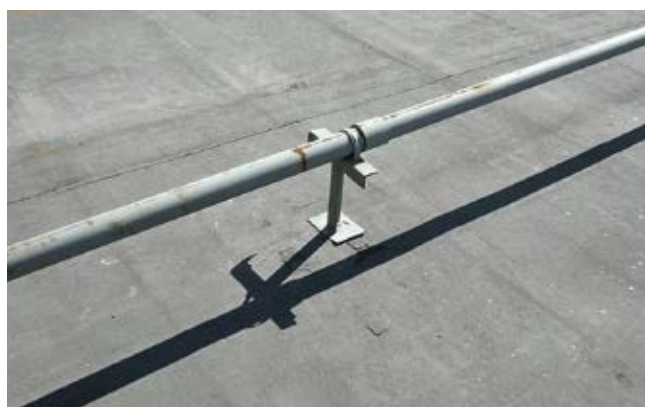
Рис. 4.21. Установка оборудования непосредственно на кровлю без устройства примыкания
