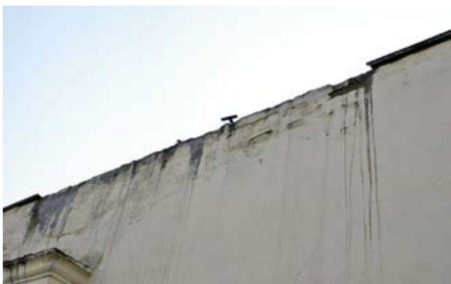
Рис. 4.17. Отсутствие картин карнизного свеса
