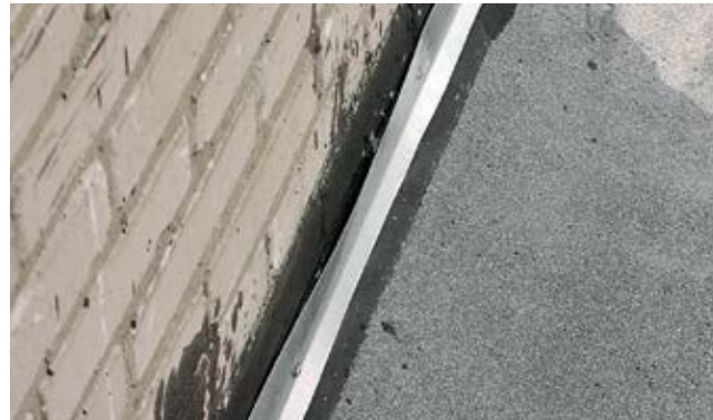
Рис. 4.14. Отсутствие герметика на верхнем отгибе защитного фартука
