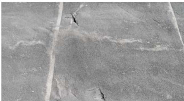
Рис. 4.3. Механическое повреждение кровли
