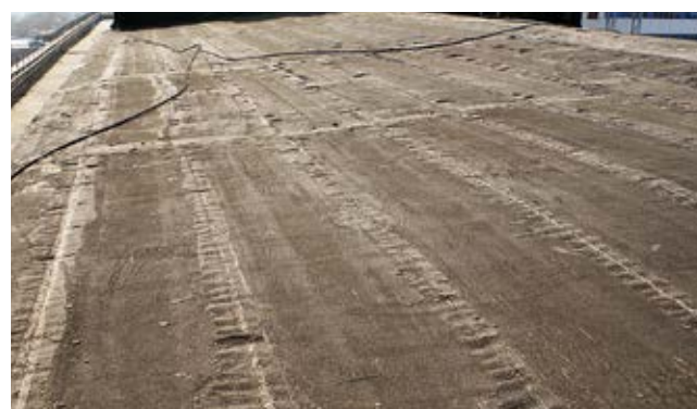
Рис. 4.2. Отсутствие защитной крупнозернистой посыпки
