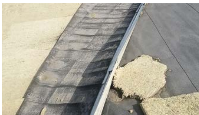
Рис. 4.1. Отрыв кровельного ковра от основания
