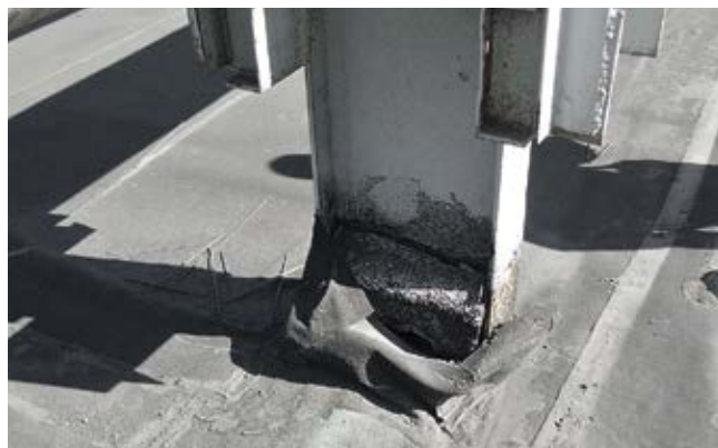
Рис. 4.22. Неправильное выполнение примыкания
