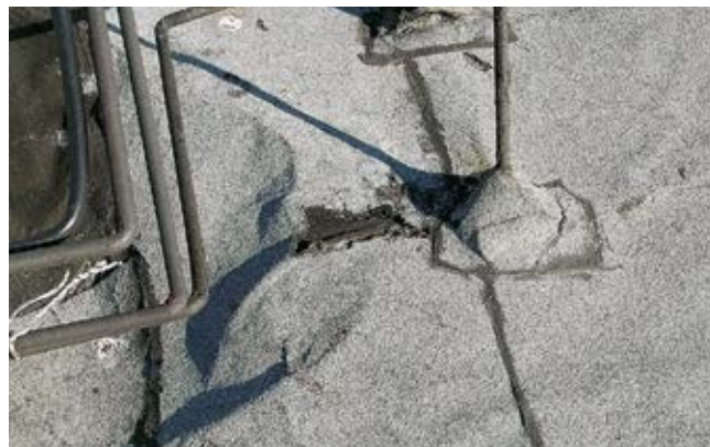
Рис. 4.19. Ошибки в устройствах примыкания к элементам крыши
