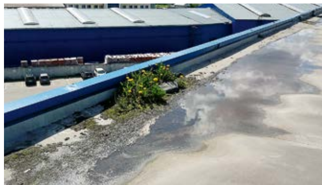
Рис. 4.6. Биологическое разрушение кровли
