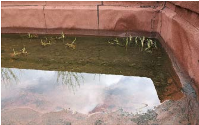
4.16. Засорение водоприемных воронок
