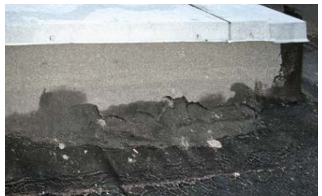
Рис. 4.11. Механическое повреждение кровли
