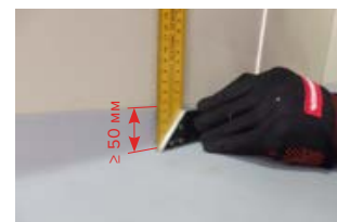
Рисунок 5.12. Заведение гидроизоляционного слоя с горизонтальной на вертикальную часть кровли при устройстве примыкания
