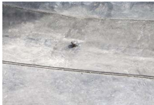
Рис. 3.6.8. Повреждение мембраны шляпкой самореза при применении тарельчатого металлического держателя по минераловатному утеплителю.
