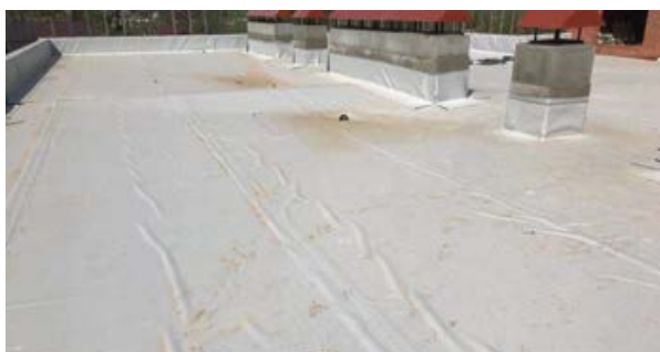
Рис. 5.4.6. Появление волнистости на поверхности смонтированной ПВХ-мембраны.
