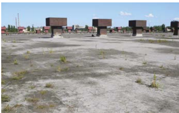
Рис. 2.4.5. Старая рулонная кровля до ремонта.
