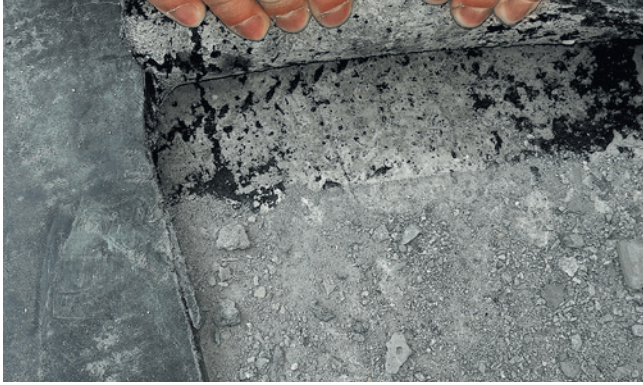
Şəkil 3.6. Tozlu səth üzərinə praymerin vurulması səbəbindən materialın bünövrəyə yapışqanlığının olmaması
